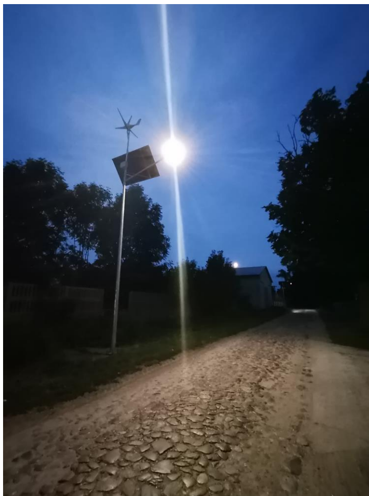
Fot. 9. Lamy solarno – wiatrowe w Skoraszewicach
